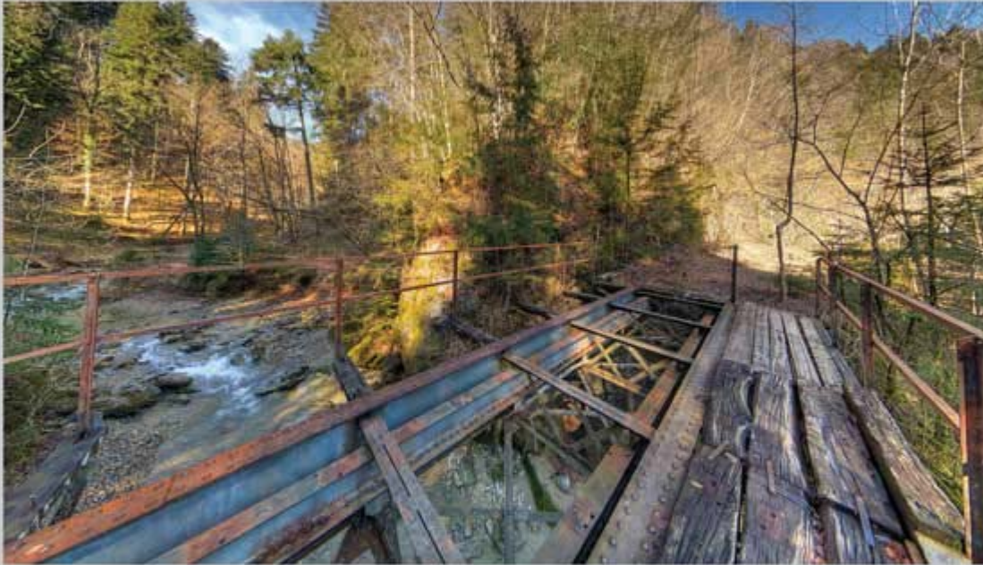
Die Rickenbachbrücke über den Wirtatobelbach. Bis 2005 lagen hier noch die Bahnschwellen. 2005 wurden diese vom Hochwasser weggespült. Nur der Weg auf der rechten Seite wurde wieder hergestellt.
